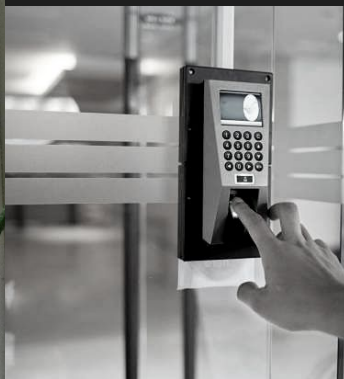
ระบบควบคุมประตู เข้า-ออก
