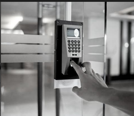
ระบบควบคุมประตู เข้า-ออก
